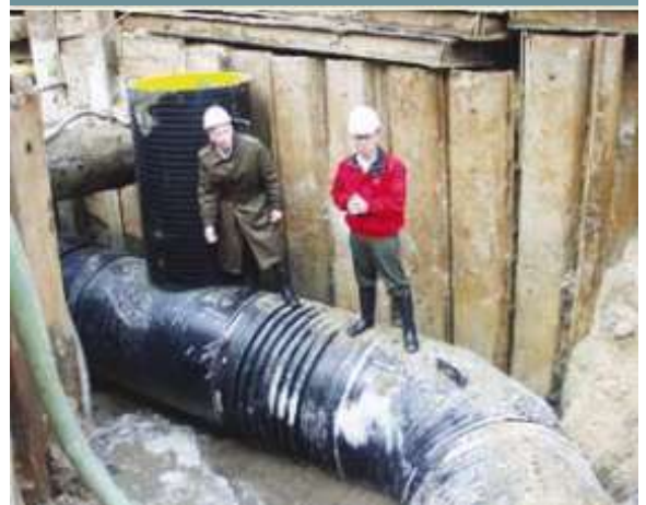
Avløpsledning DN/ID 1200 mm med bend og nedstigningskum.
