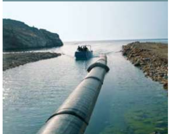
Utslippsledning DN 2000 mm.
